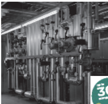
Управление насосной станцией
